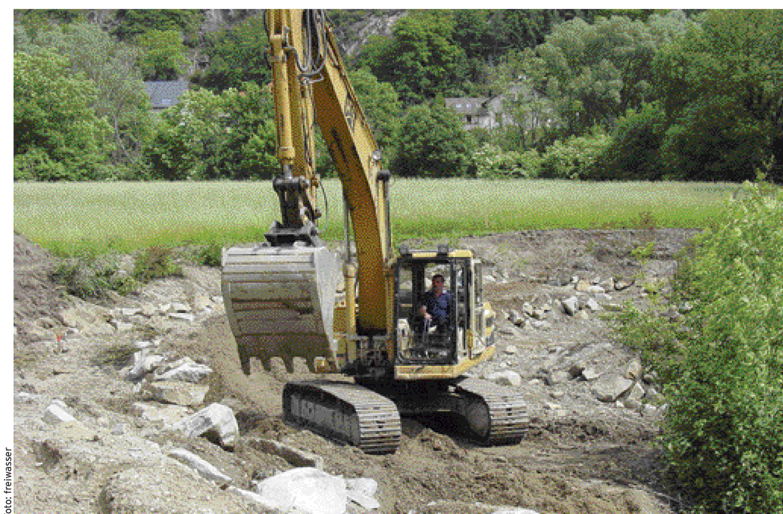
Der Umgehungsbach während des Baugeschehens. Die Sohle ist mit Schotter ausgelegt, Blocksteine zur Uferbefestigung werden eingebaut. Zeitweise waren zwei Bagger beschäftigt.
